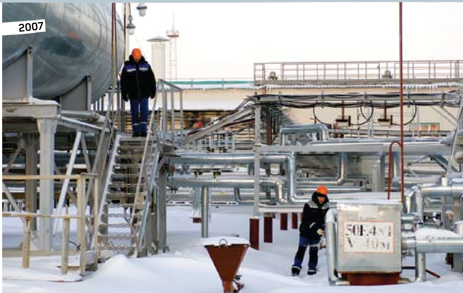
Impianto di produzione e trattamento Novy Urengoy, Russia, 2007
