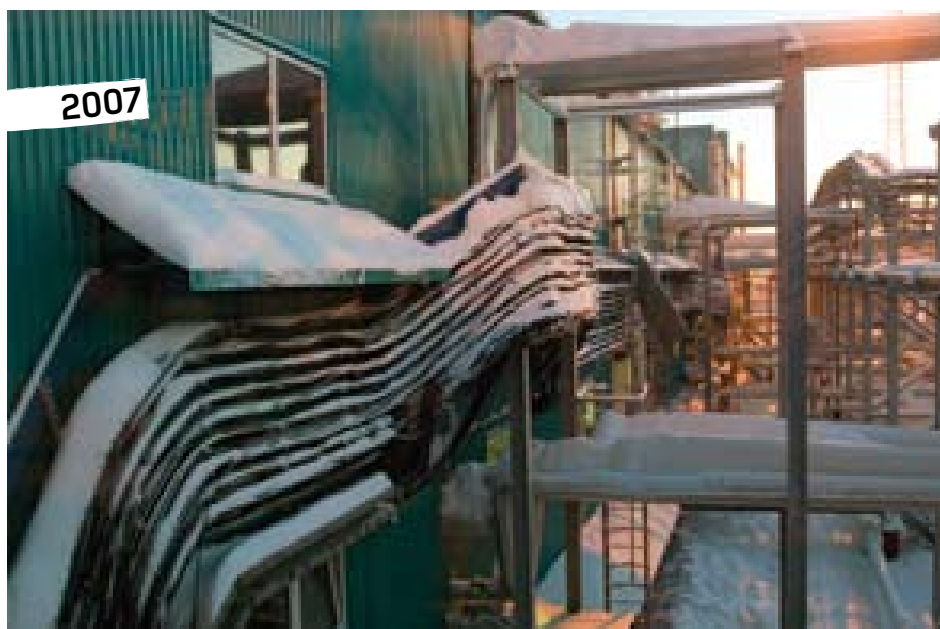
Impianto di produzione e trattamento Novy Urengoy, Russia, 2007
